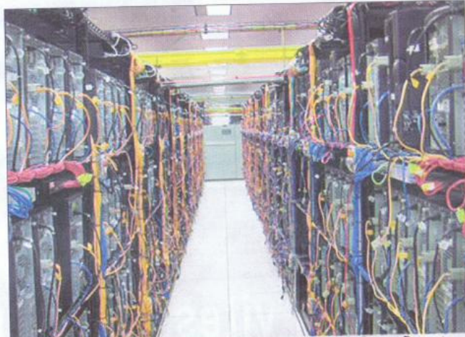
La Green IT ou informatique verte est arrivée par les économies d'énergie. Dans un Datacenter (centre de données), l'informatique est responsable d'un tiers de la consommation électrique, le reste concerne la climatisation et l'alimentation électrique
